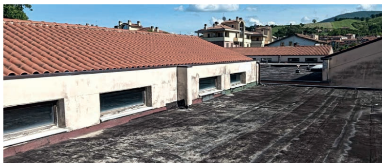
La scuola dell'infanzia del Borgo ha necessità di un importante intervento per eliminare l'annoso problema delle infiltrazioni
